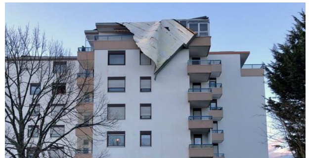
Sturm Sabine hat im Februar 2020 die Abdeckung eines Hochhauses in der Esternaystraße in Etzenrot weggerissen.
